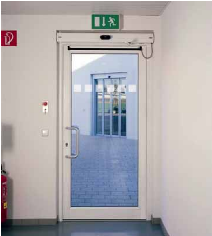
Bild 17: Kennzeichnung eines Flucht- und Rettungsweges
